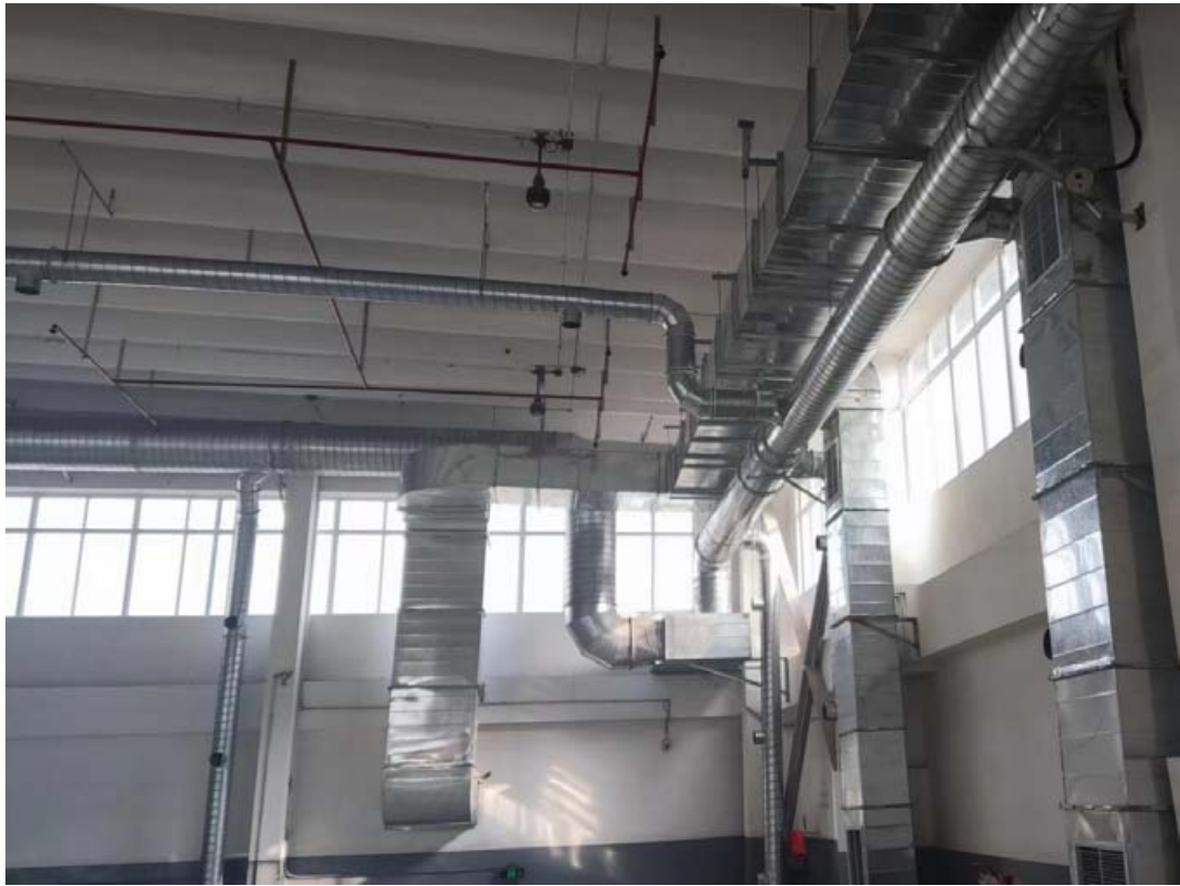
B5 仓库内部集气设施
