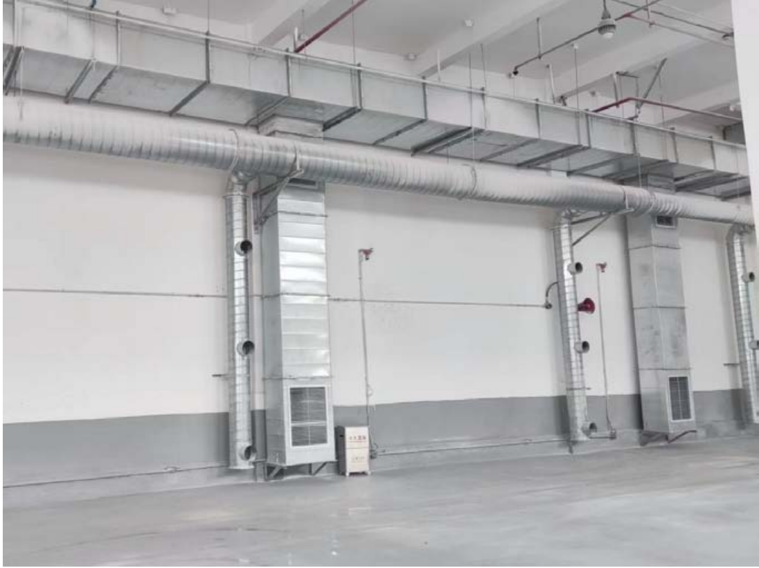
B7 仓库内部集气设施
