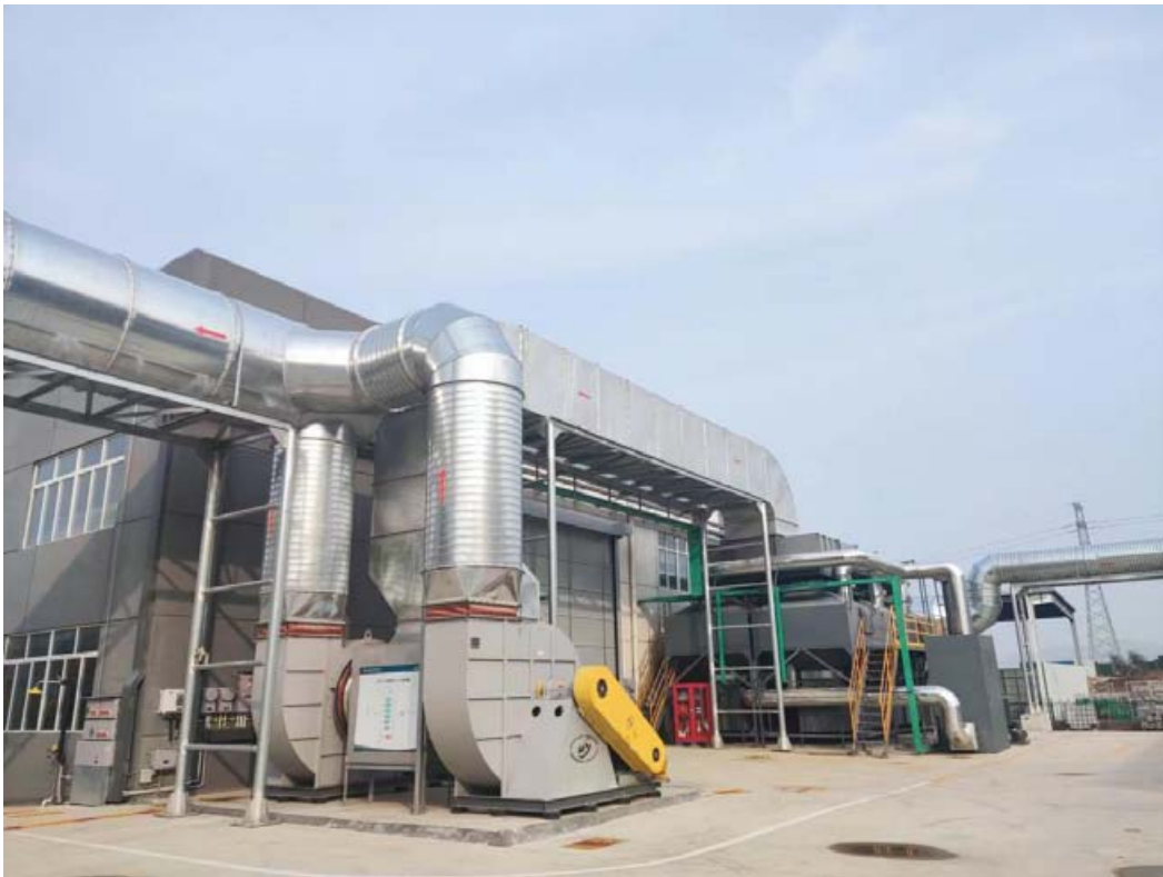
B5、B7 仓库废气处理设施
