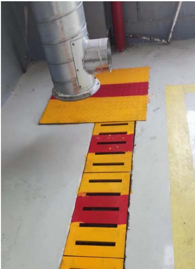
仓库内部导排沟、收集井
