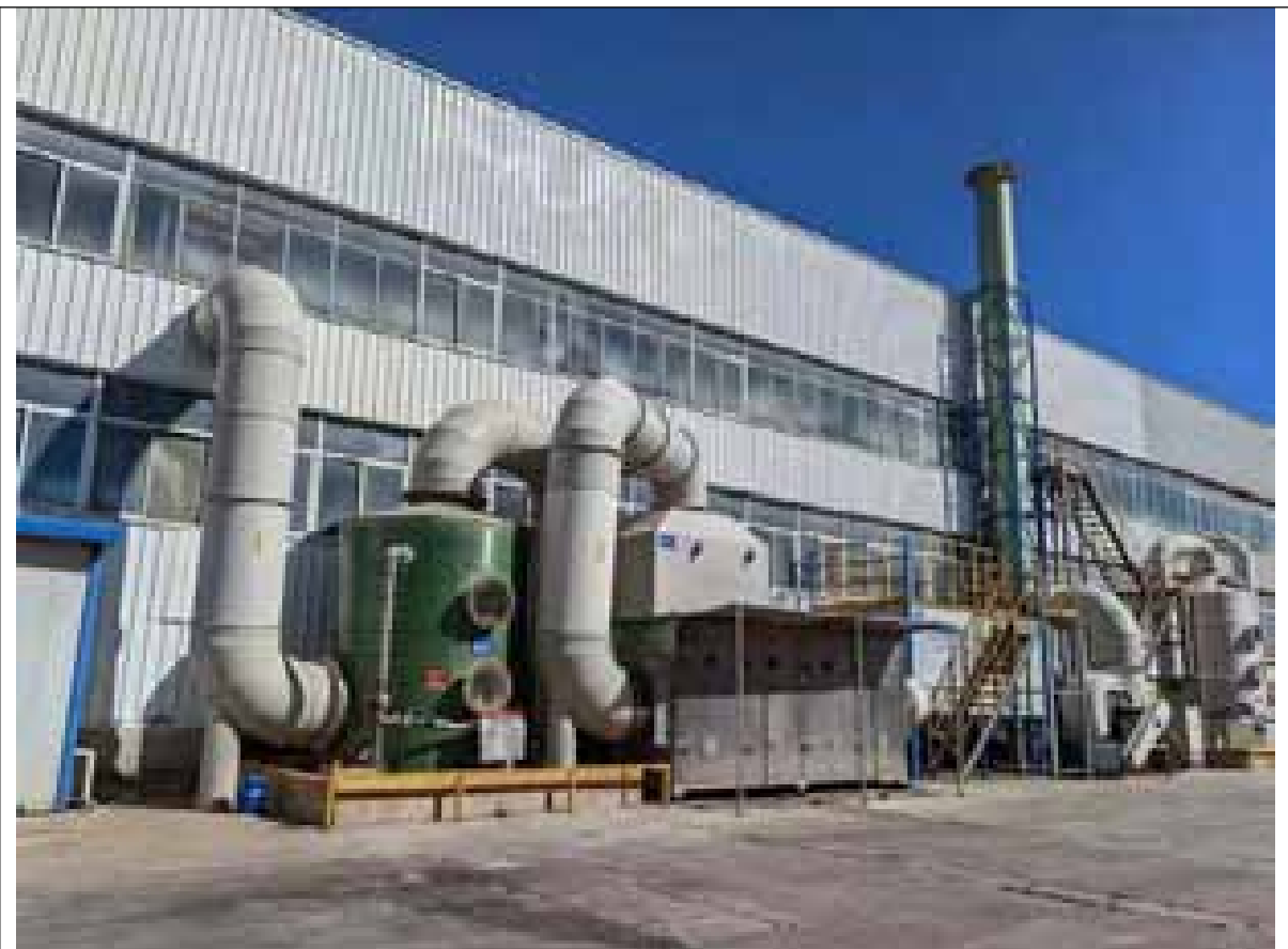
图 4.1-3 现有污水处理站废气处理照片
