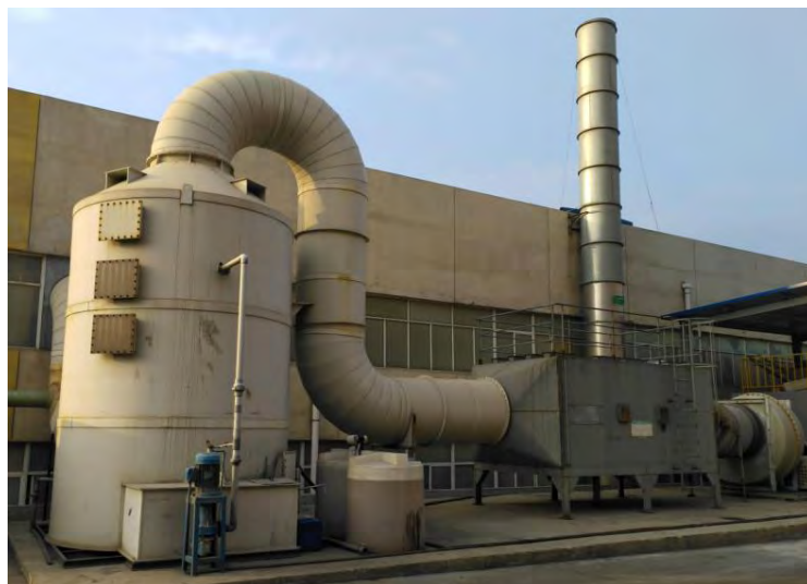
图 3.4-12 B6 危废储存库废气处理系统
