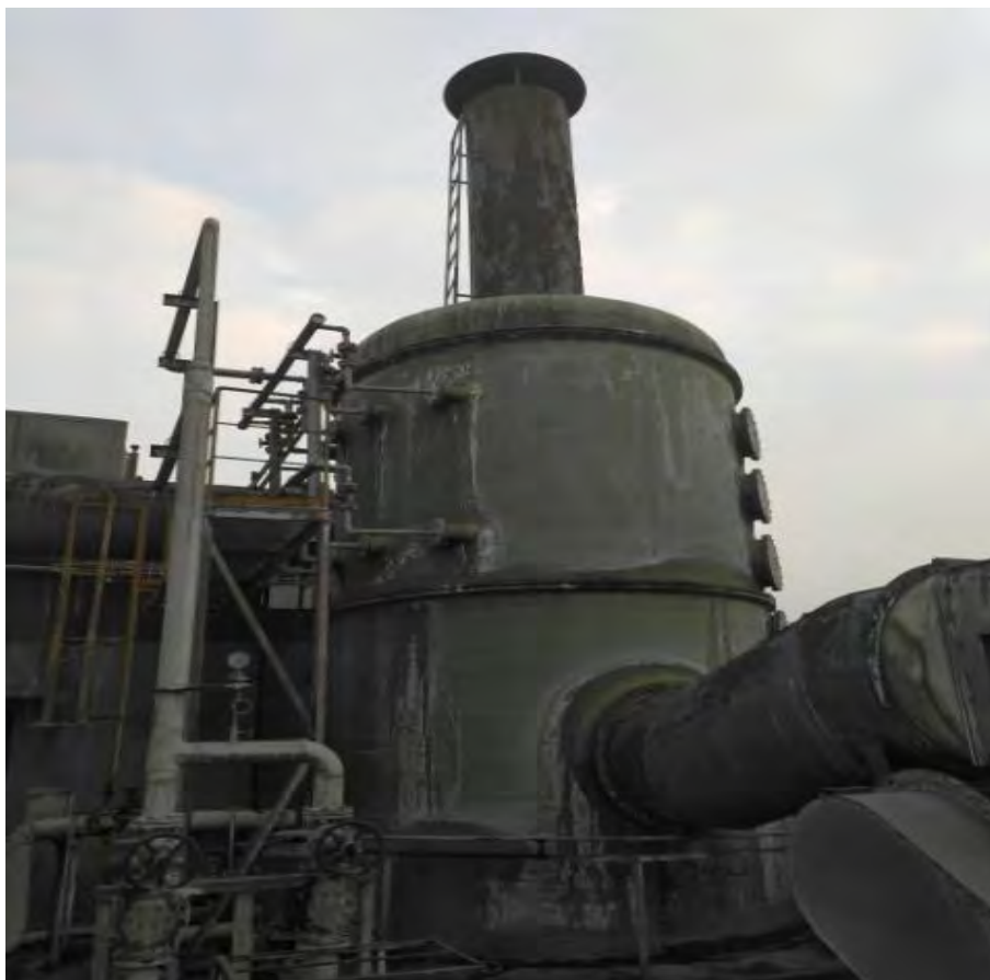
图 3.4-14 焚烧车间料坑废气处理系统
