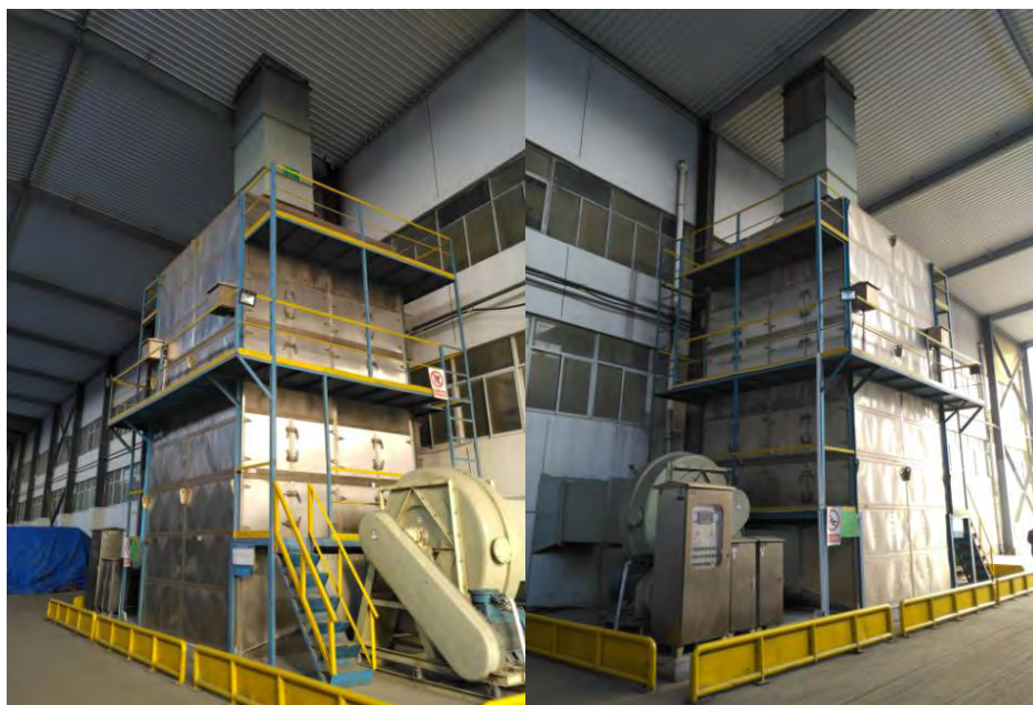
图 3.4-13 B5 危废储存库废气处理系统
