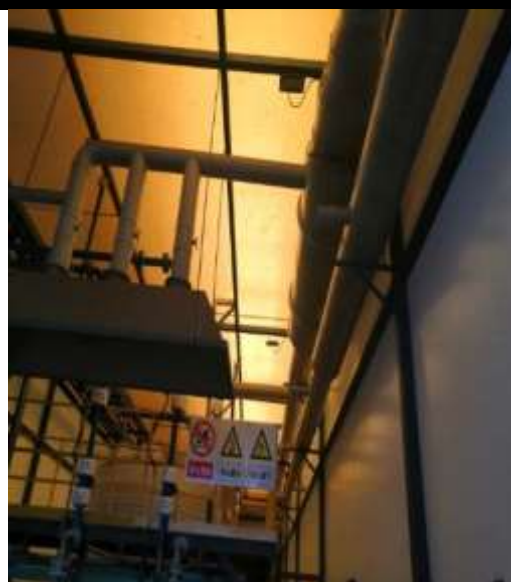
卸酸区废气收集管道
