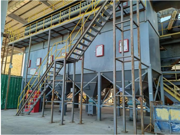
旋风除尘+布袋除尘器
