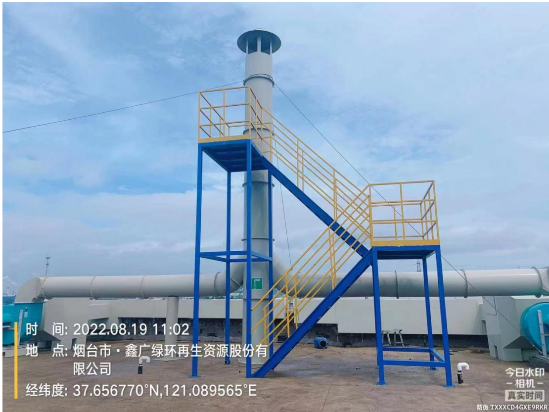
实验室排气筒
