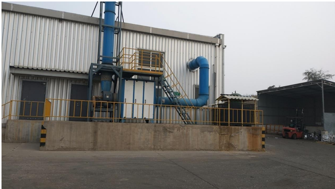
水帘+活性炭吸附+P4 排气筒及采样平台
