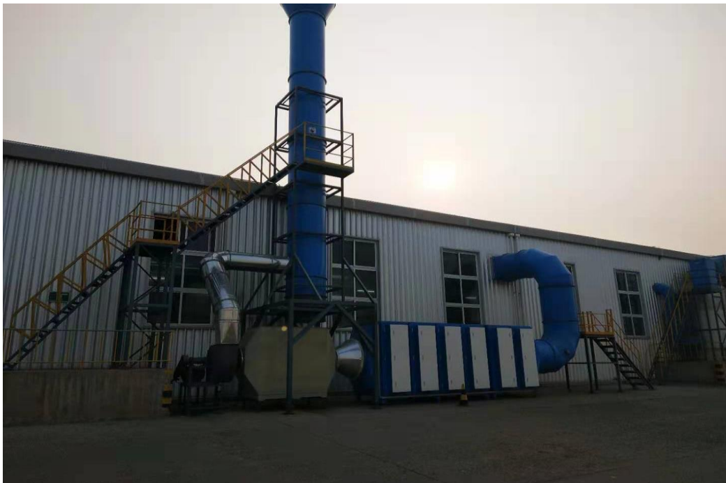
低温等离子+光氧催化+活性炭+P2 排气筒及采样平台
